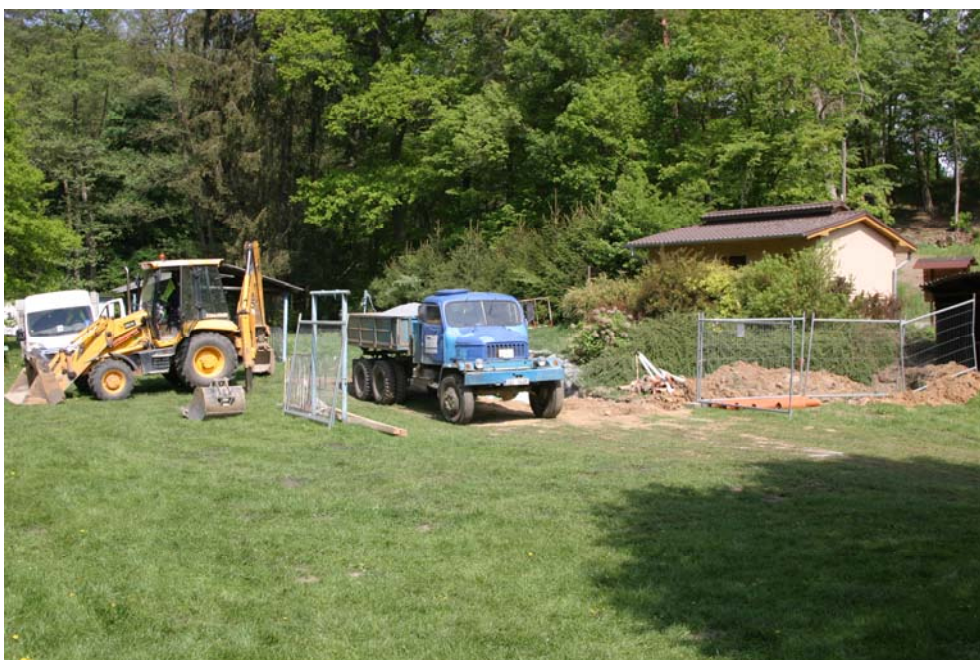
Plovárna byla před sezónou těžce poškozena hloubením výkopů a pojezdem těžké techniky (včetně pokračujícího vyvážení jímky fekálním vozem po celou sezónu)
